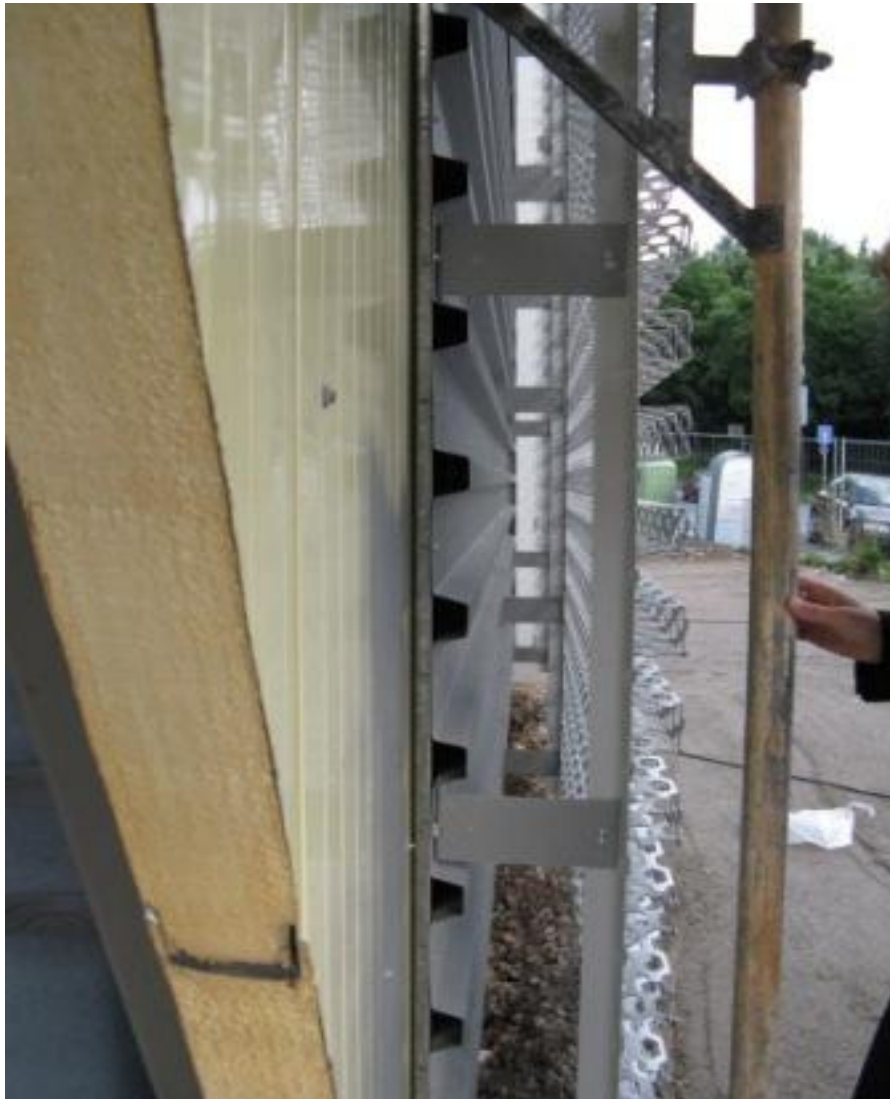
Beispiel: Detailaufnahme Unterkonstruktion mit verschraubten Aluprofilwinkeln + Seitenwinkeln auf Unterblech Fassade Hier: einfache Verschraubung zwischen den Wellen des Trapezbleches Verschraubung der Lochblechpaneele auf den Aluprofilen
